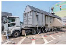
代替非常用発電機(常設)
