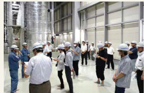
北海道電力ネットワーク南早来変電所の大型蓄電池
